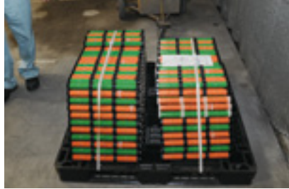
取り出されたモジュール部分
