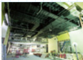
ダクト類は鋼材の上に配置し、直接天井に落下しない構造に
