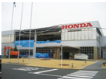
品質改革センターでは 建物正面のガラスが広い 範囲で割れた
